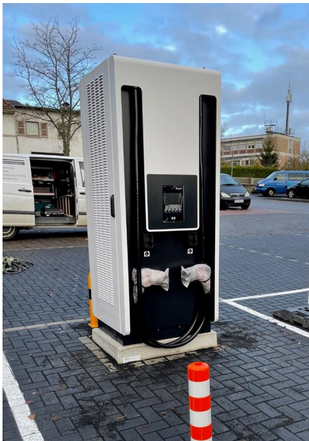
Abbildung 8 Aufgestellte Schnellladesäule am Parkplatz „Katholische Kirche“
